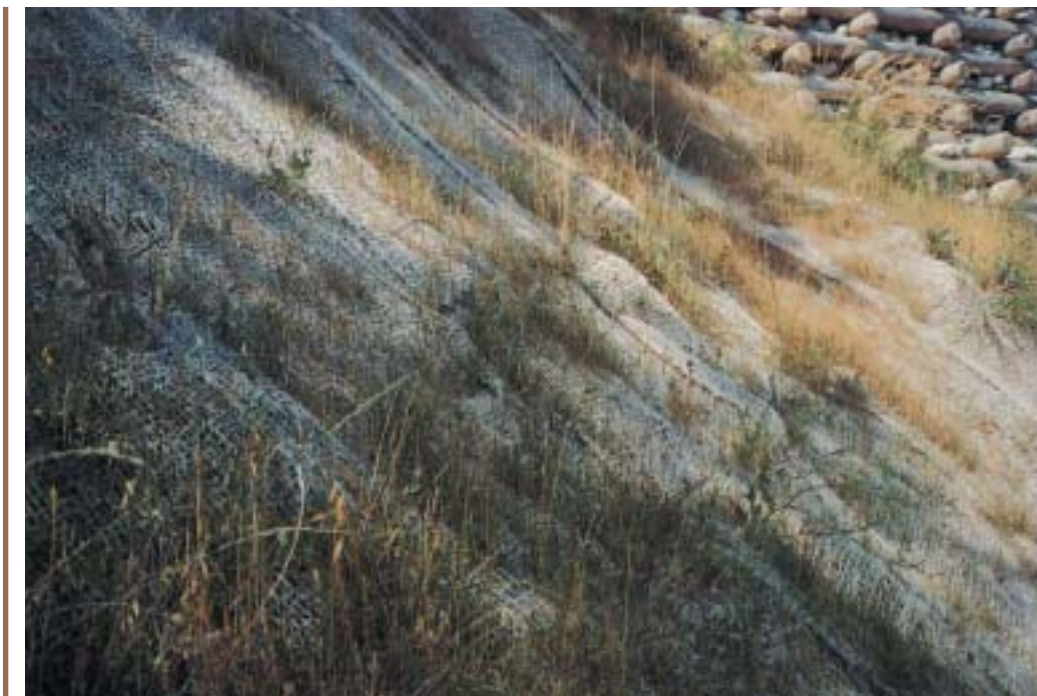
Sistemazione con reti o stuoie in fibra naturale ed inerbimento nel contesto di interventi di consolidamento di una frana (Frana Cima Gogna, Cadore - BI)
