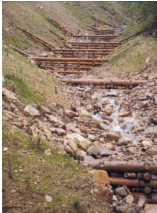
Briglia in legname e pietrame con rinverdimento delle sponde attraverso la messa a dimora di talee ( Rio Parabelun, Val del Boite - BI ).
