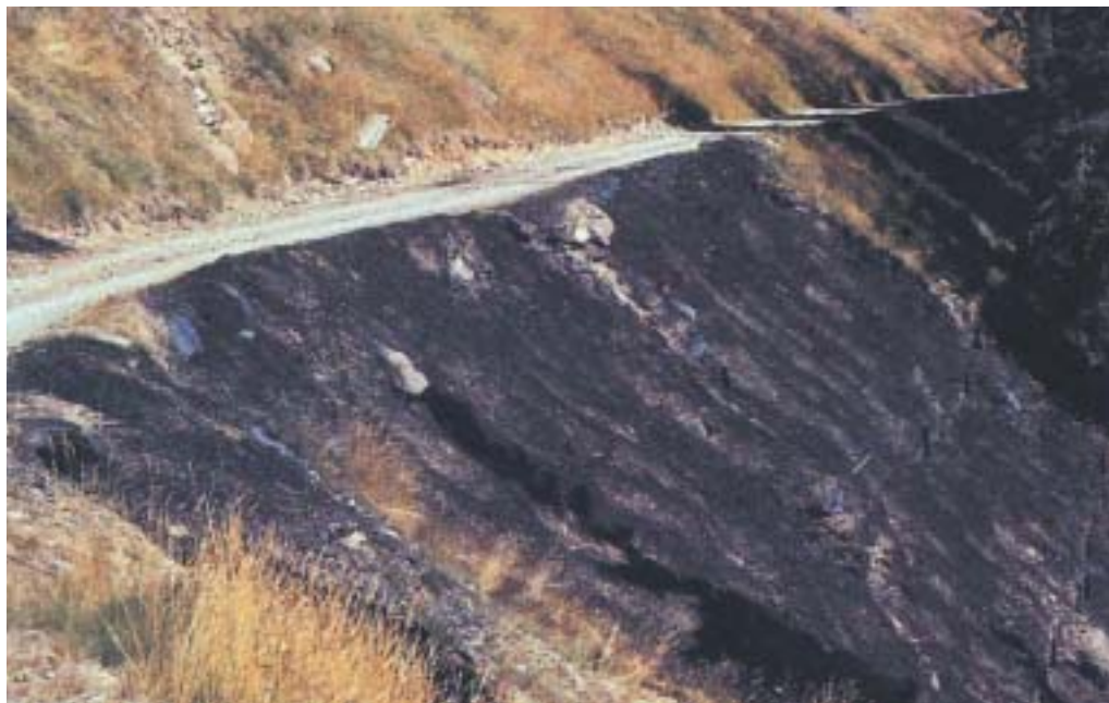
Palizzata in legname ed inerbimento con coltre protettiva di paglia e bitume - fase di realizzazione - (Val d'Ultimo - Bz).
