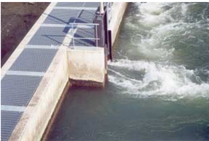
Figura 8. Grigliato protettivo calpestabile sul P.p.P. alla centrale idroelettrica di Camon - fiume Garonna, Francia (foto Pini Prato)
