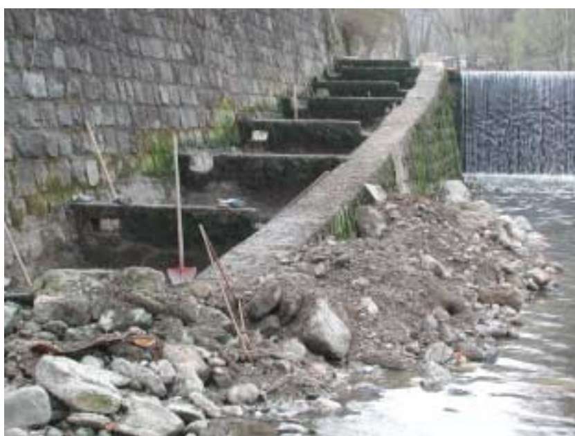
Figura 7. Ripulitura dai materiali fluitati di un P.p.P. sprovvisto di sistemi di protezione (foto ing. T. Putelli)
