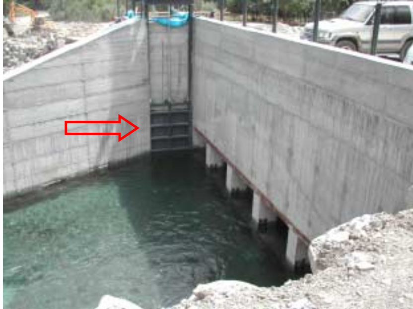
Figura 10. Paratoia automatizzata con controllo radio-GSM in un P.p.P. sul T.Lima (foto e progetto Pini Prato)
