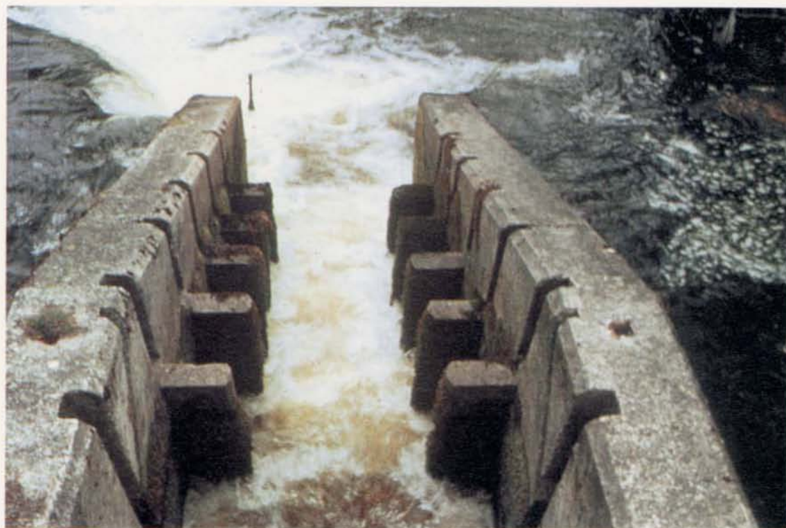
7 - Ballina fish counter, River Bunree (Ireland): particolare della parte superiore di questo Denil fish pass, dotato di automatic fish counter e trash screen.
