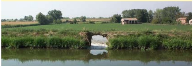
Cedimento argine del Sabbioncello per i buchi fatti da nutrie
